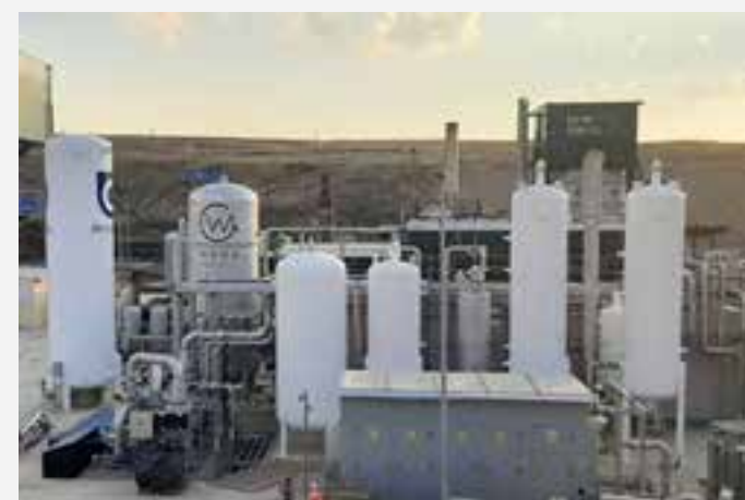
La WAGABOX® sur le site espagnol de stockage de déchets de Can Mata
